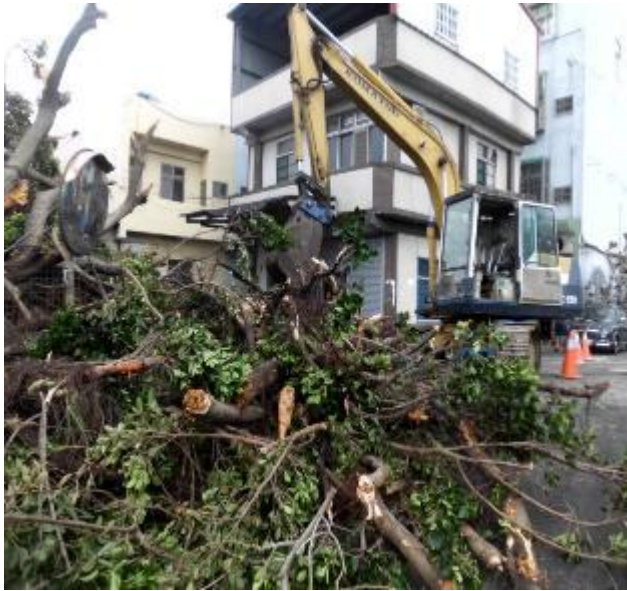
(災害現況照片)
